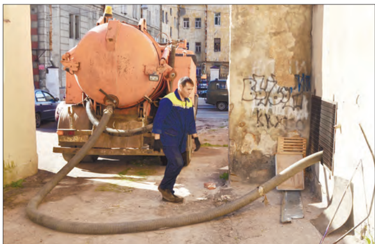
Откачка ила из подвала на Крепостной, 3
